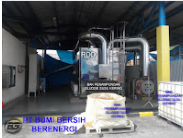
Gambar 7. Proses Pengolahan Sludge Susu Menggunakan Mesin RDD.
