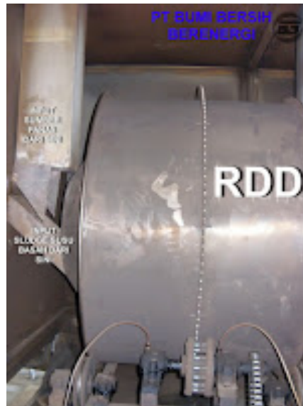
Gambar 6. Instalasi Mesin RDD Pengolahan Sludge Susu.
